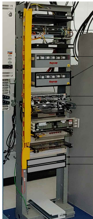
EXISTING BBU/OVP RACK
